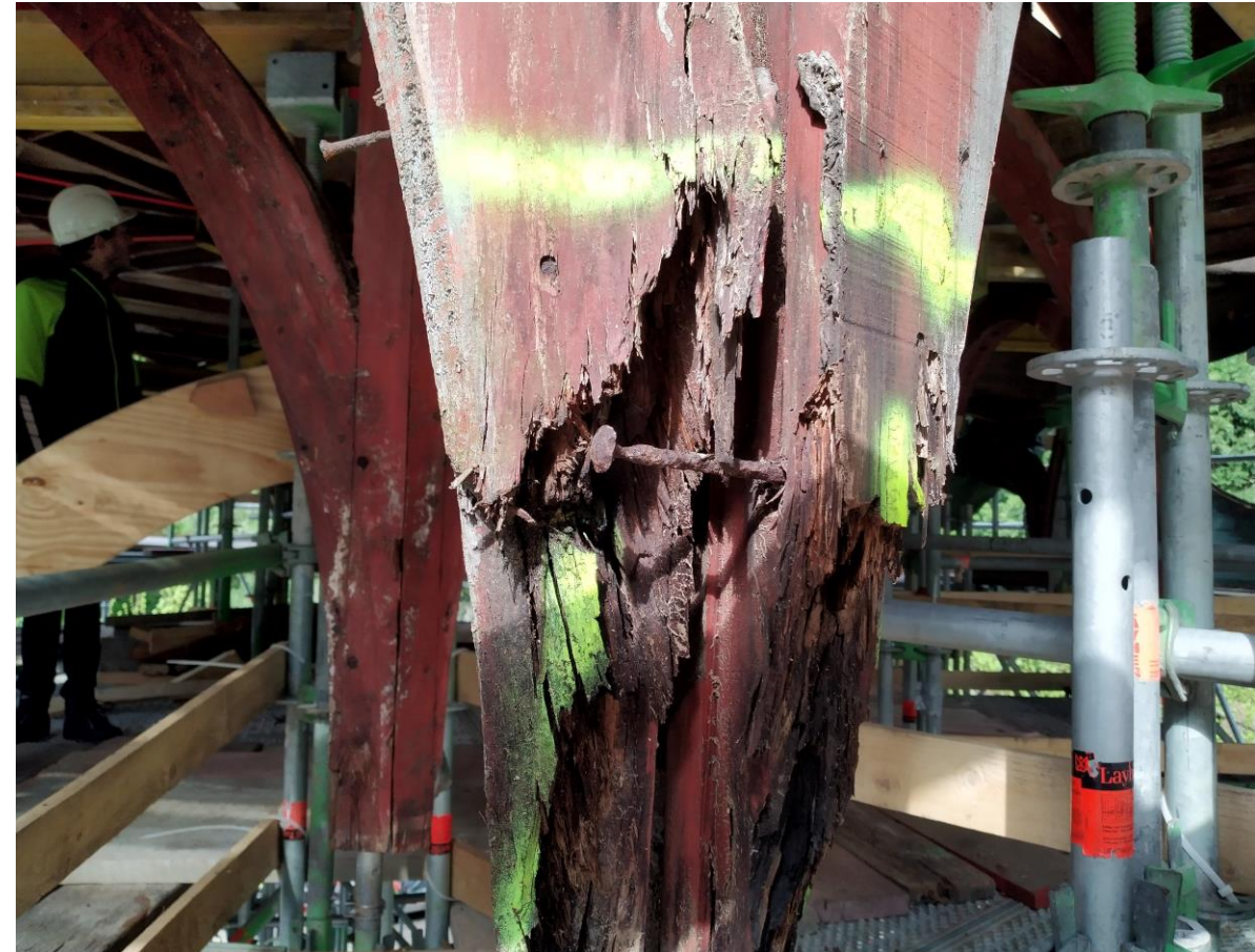
Aangetaste voeten dakconstructie
