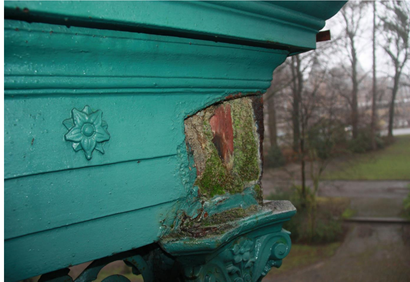
Zware corrosieschade (detail van entablement) 10
